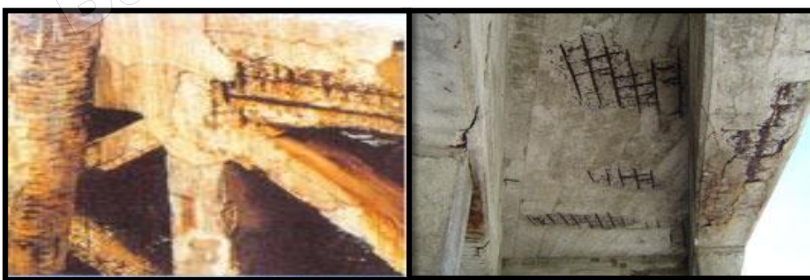
รูปที่ 2.7 แสดงลักษณะการทำลายของสารประกอบซัลเฟตต่อคอนกรีต [14]
