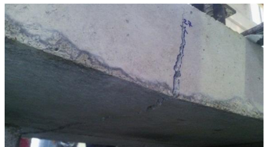
การแตกของพื้นคอนกรีตเสริมไม้ไผ่เคลือบอีพ็อกซีฟันทรายจากผิวด้านล่างขึ้นสู่ด้านบน
